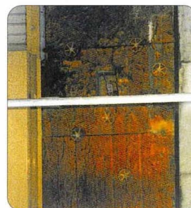
Typischer Feuchtigkeitsschaden mit biologischem Befall
