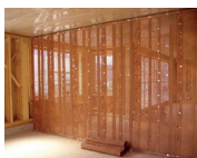
Stabile Innenwände mit hohem Schallschutz
